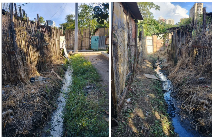
Figura 7 - Esgoto sem tratamento
